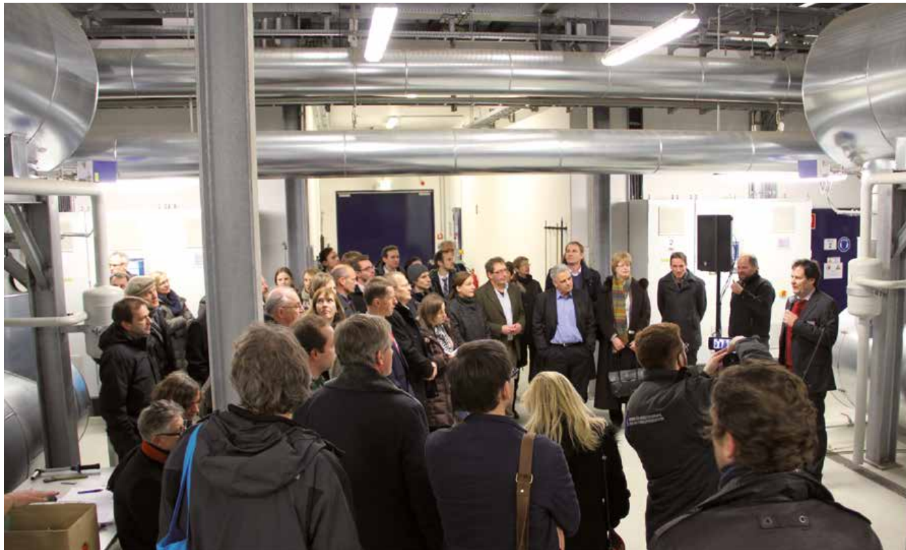
Speichertechnologien für die Energiewende waren Thema der ersten Adlershofer Technologietour Energy storage technologies were the topic of the first Adlershof Technology Tour
