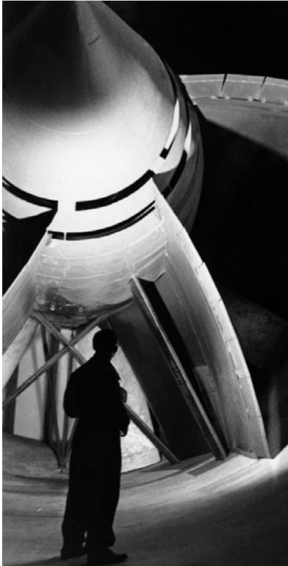
Antriebseinheit des „Großen Windkanals“, der Durchmesser beträgt 8,50 Meter. Der Antriebsmotor entwickelte 2.200 Kilowatt Leistung.
