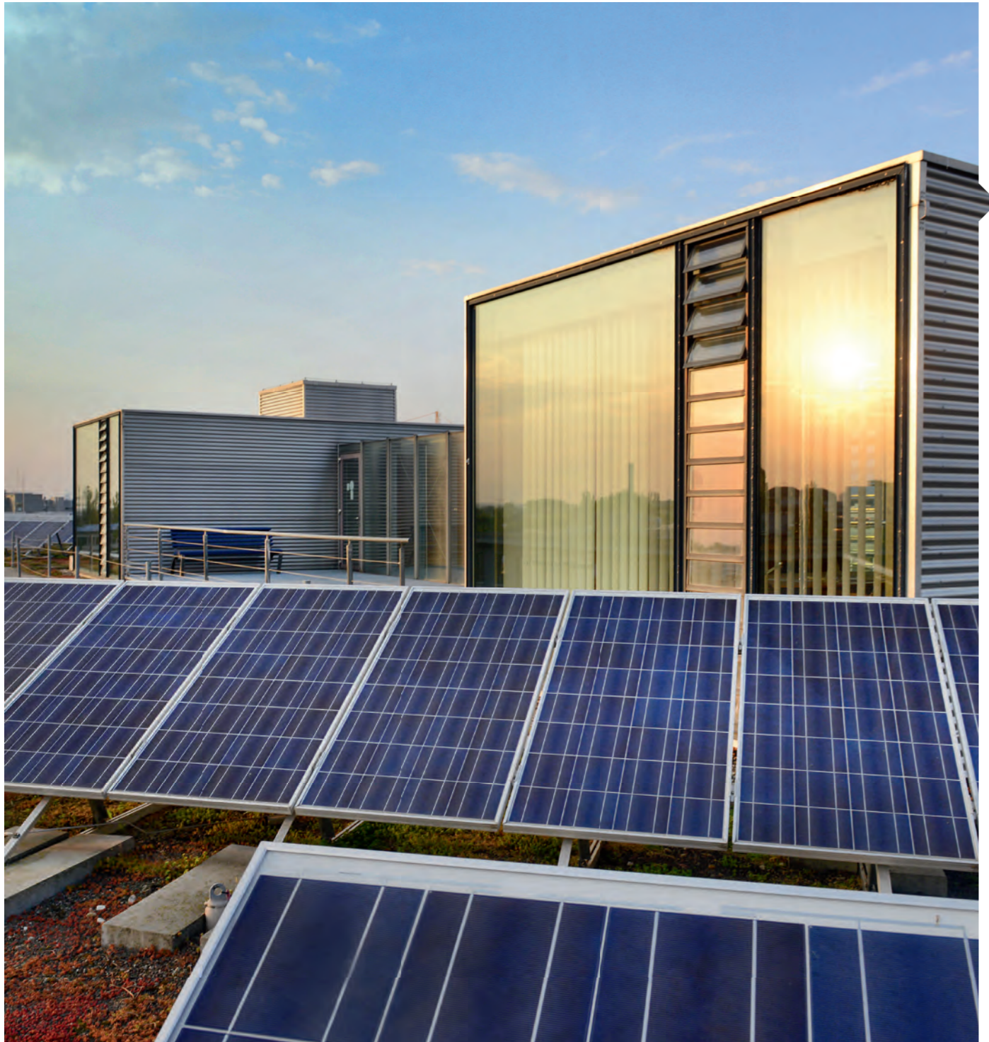
Technologie für Zukunftsenergien: Solaranlage auf dem Zentrum für Biotechnologie und Umwelt Future energy technology: solar panels on the rooftop of the Centre for Biotechnology and Environment
